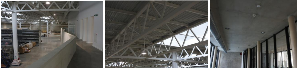
De nombreux détecteurs de présence Theben PIR 360° et 180° installés sur l'ensemble du site
